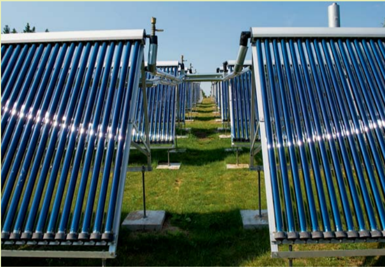
Rahvusvahelise keskkonnamärgise Roheline Vöti nõuetele vastav Pühajärve puhkekodu rajas KIKI toel biokütusel töötava katlamaja koos päikesekütesüsteemiga. Sooja vee tootmiseks paigaldati katlamaja katusele 400 m 2 päikesekollektoreid koguvõimsusega 0,3 MW. August 2014, Valgamaa.
